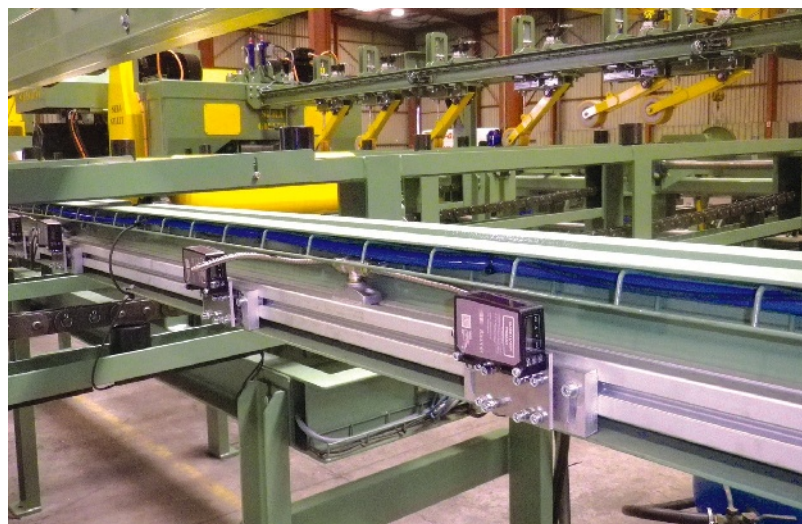
Rampes inférieures de scannage afin d'améliorer l'optimisation.
