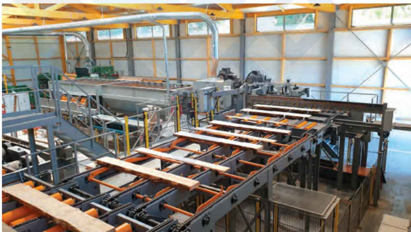
Passage automatique des produits sous la rampe de scannage avant cantérisation des bords et délignage. Au fond à droite, la multilames Storti pour la repasse automatique des équarris restant du débit au canter-déligneuse.
