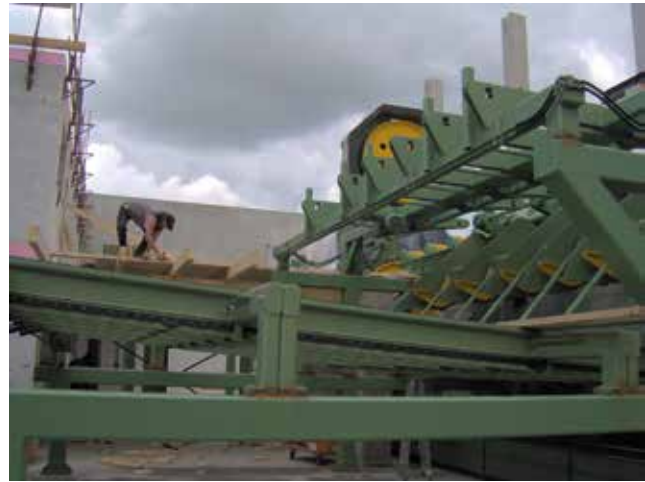
Installation d'un process de sciage gros bois au cœur d'une scierie allemande possédant deux lignes de canter débitant 500 000 m 3 de grumes par an.
