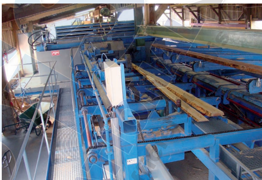
Le centre de délignage MEM reçoit les produits de rive ou les noyaux de ruban.
